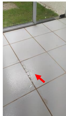
FOTO 7: Infiltração em quarto PPP
