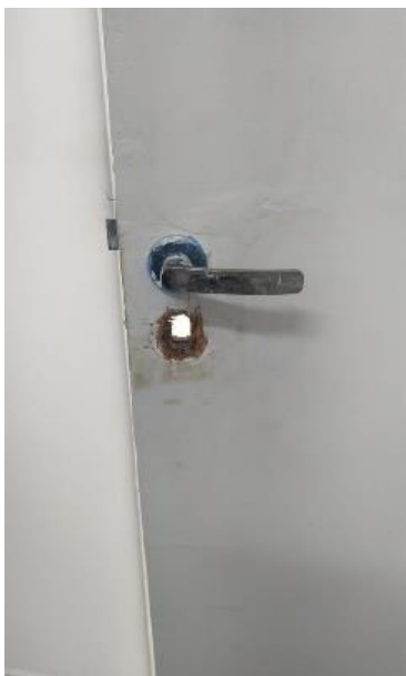
FOTO 18: maçaneta e portas danificadas.
