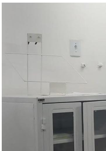
FOTO 17: suporte de caixa de perfuro cortante não instalado
