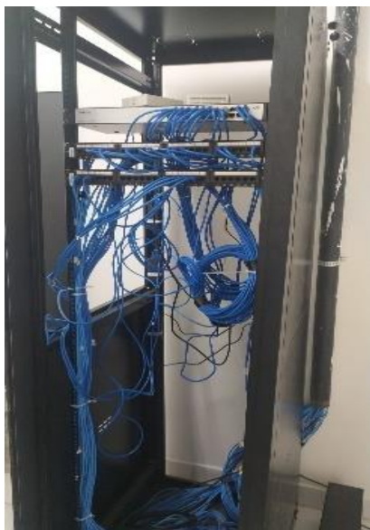
FOTO 13: Recursos mínimos presentes na estrutura de rede, A estrutura apenas dois patchs painel para o cabeamento estruturado, um switch 48 portas que faz a distribuição do sinal da rede interna e um roteador microtick que fornece a internet
