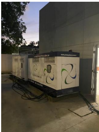
FOTO 1: Localização dos geradores no CPN
