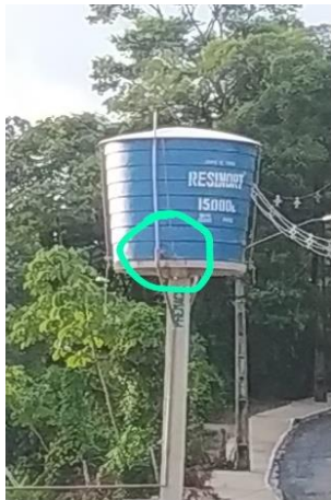
FOTO 3: Fissura no tanque de água geradores no CPN
