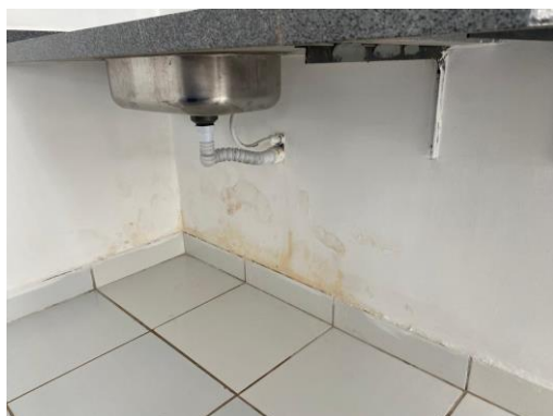
FOTO 8: Infiltração sala de acompanhantes
