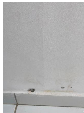
FOTO 9 : Infiltração sala de acompanhantes com presença de fungos
