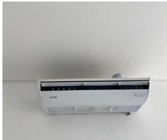
FOTO 25: ar condicionado sem funcionar
