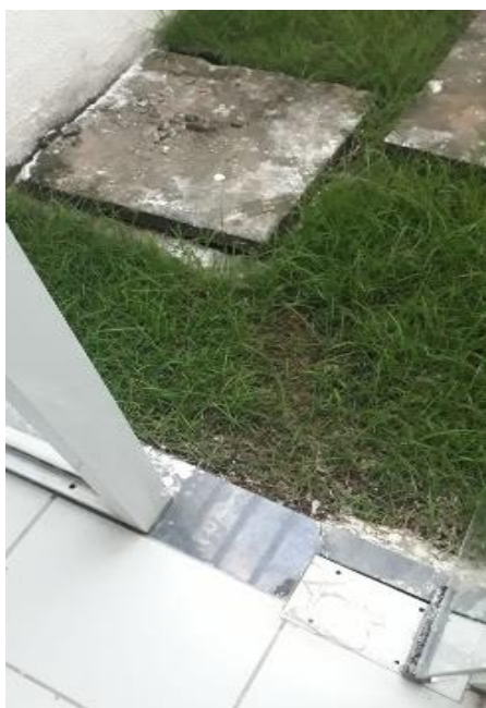
FOTO 19: tampas das caixas de esgoto/água abertas nos quartos PPP
