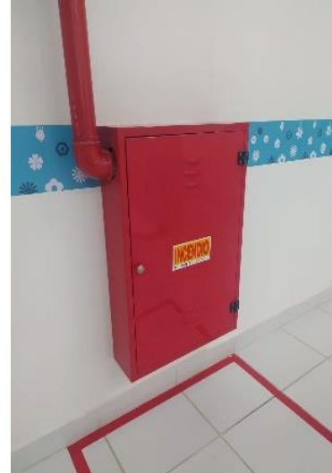
FOTO 12: Mangueira do hidrante sem fornecimento de água em tubulação, sem identificação
