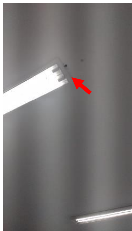
FOTO 5: Infiltração em teto, próximo à rede de energia
