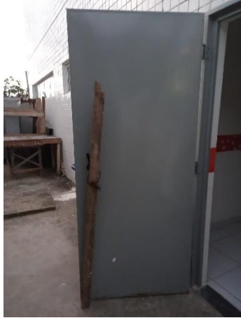
FOTO 27: Estruturas das portas quebradas e sem fechamento
