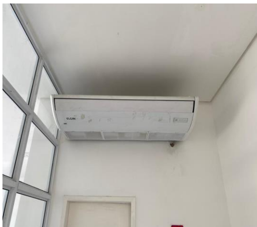
FOTO 24: ar condicionado sem funcionar
