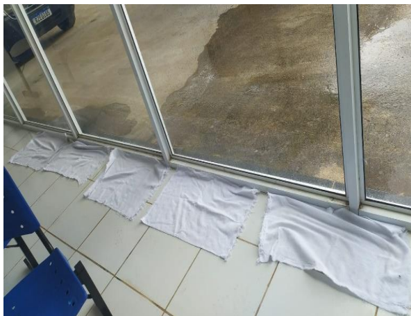
FOTO 6: Falta de vedação em portas da sala de eventos
