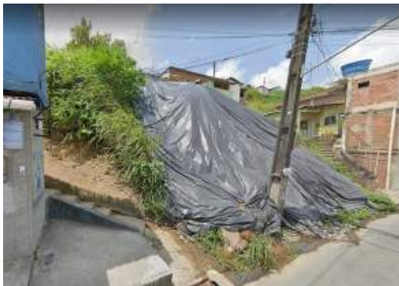
Figura 37 - Problema de deslizamento de terra na Zona de Adensamento Baixo
