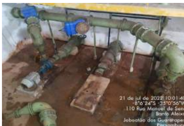
Figura 2 - Equipamentos pertencentes a ETA Manoel de Sena.
